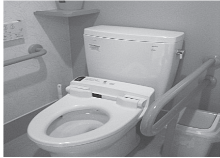
写-2 H施設 各トイレ
